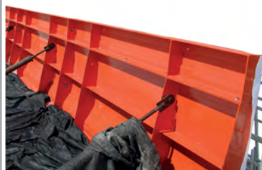
Glissière orange à séparateur de voies en béton / Orange bridge guardrail
